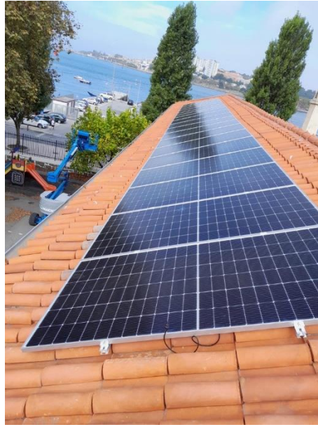
Figura 5 – Módulos fotovoltaicos na Escola Básica da Afurada
