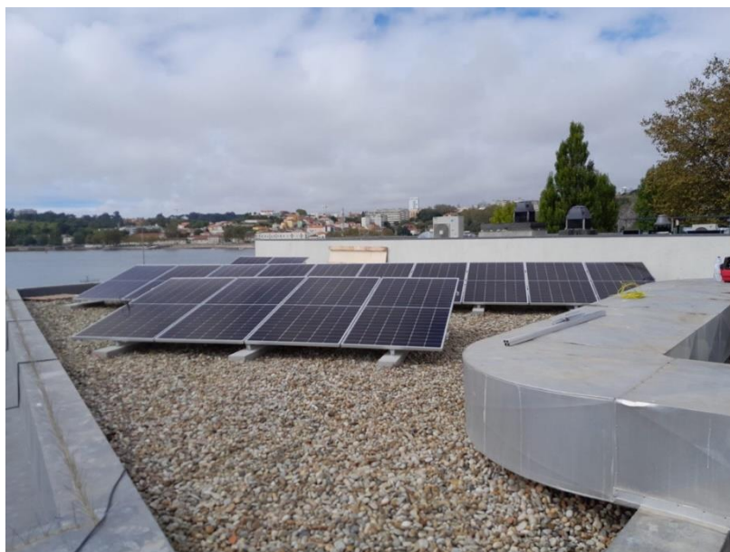
Figura 4 – Módulos fotovoltaicos no Mercado da Afurada
