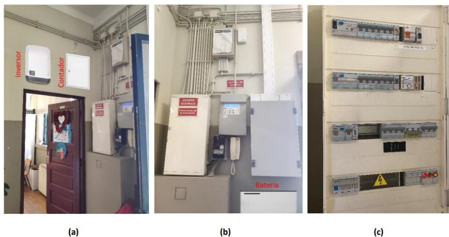
Figura 6 – Zona técnica para o sistema solar fotovoltaico da Escola Básica: a) proposta para a localização do inversor e contador de produção; b) proposta para localização do sistema de armazenamento; c) quadro elétrico de interligação.
