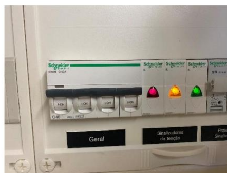
Figura 4 – Disjuntor diferencial do quadro elétrico do Centro Interpretativo
