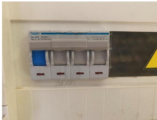
Figura 7 – Disjuntor diferencial do quadro elétrico da Escola Básica da Afurada – poder de corte de 100A.
